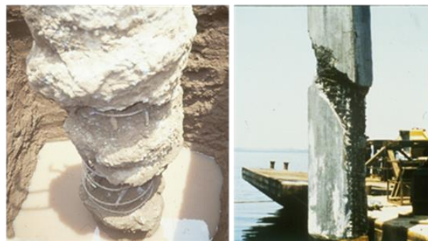
Figura 2. Patologias Identificáveis Através do Ensaio PIT.
