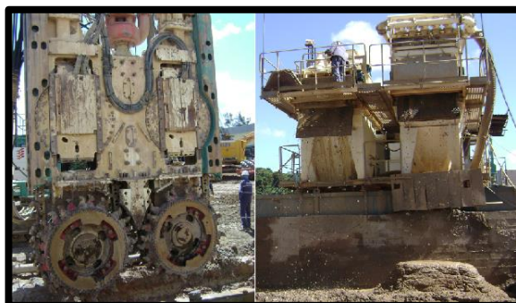
Figura 1. Hidrofresa e Central de Desarenação
